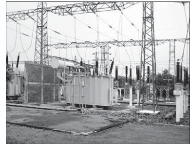
Gambar 5.24 Sebuah unit pengubah tegangan (transformator) yang digunakan PLN.
